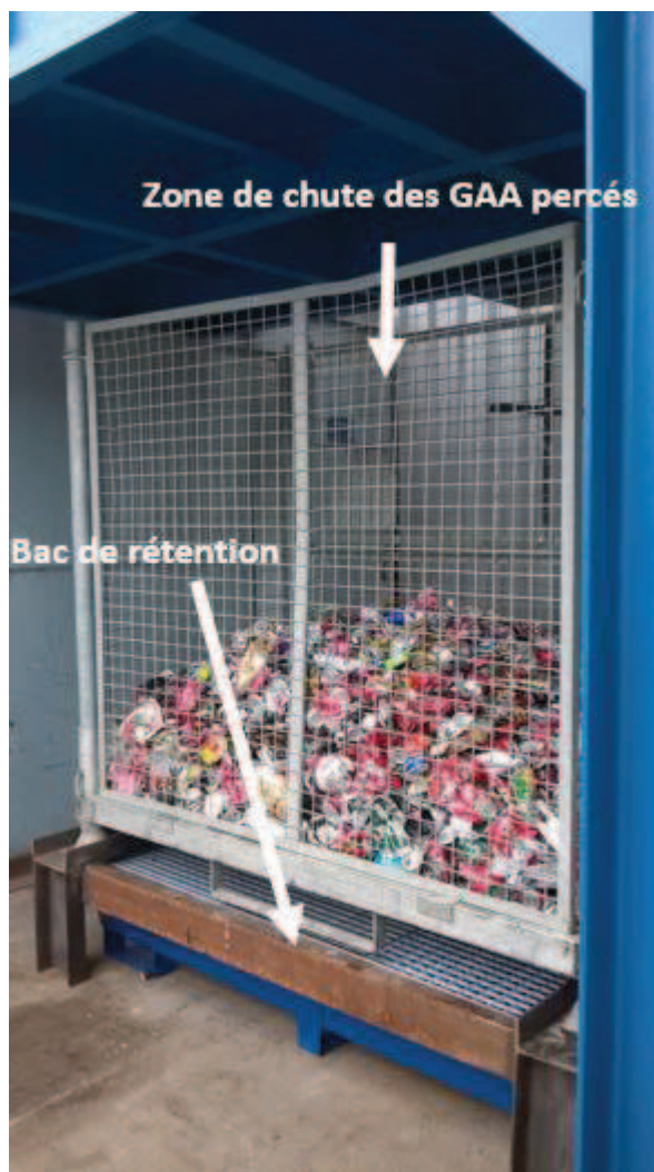
Figure 3 : Bac de récupération des DAA percés
